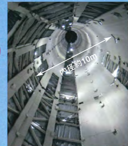
タワーの中心に直径8m、高さ375mの筒状のコンクリートで心柱をつくる
